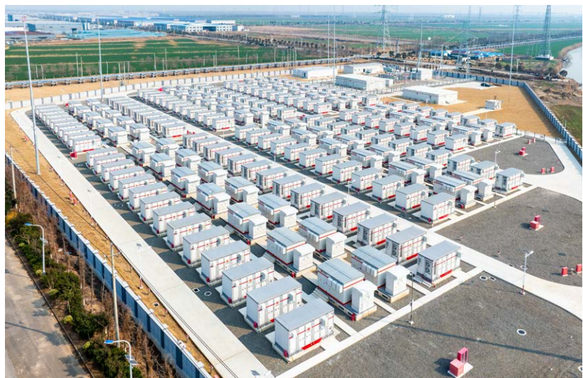
龙源江苏射阳共享储能电站
